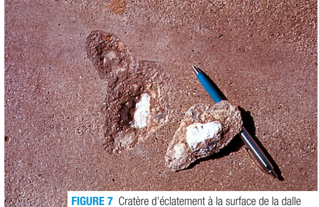
FIGURE 7 Cratère d'éclatement à la surface de la dalle
