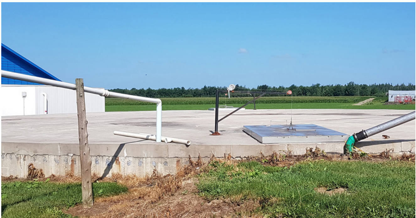
FIGURE 2 - Structure d'entreposage du lisier de porc (2)
