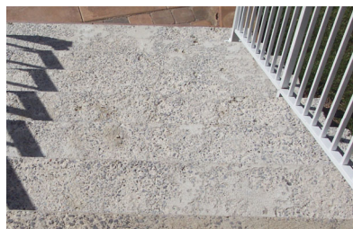
Exemple d'écaillage sévère
