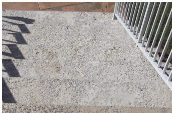
Exemple d'écaillage sévère
